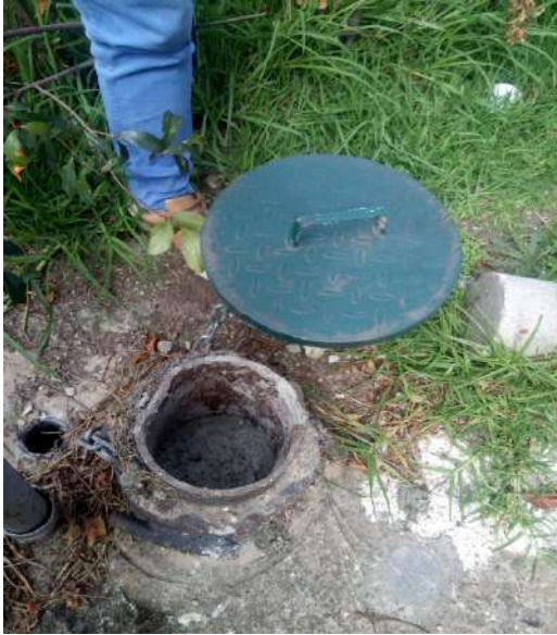
Fotografía 5. Boca pozo pz-11-0014, concreto en la tubería.
