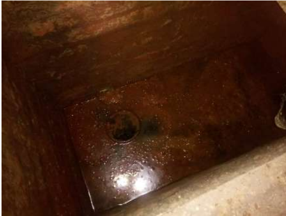
Fotografía 1. Ubicación del pozo con pz-11-0015, sótano parqueaderos, parqueadero 049.
